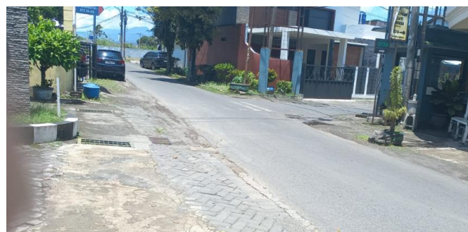
Gambar 2. Tutup Kisi-kisi Selokan pada Bak Kontrol dan Tutup Kisi-Kisi Selokan Lama Letak Elevasinya Lebih Tinggi daripada Jalan Beraspal.
