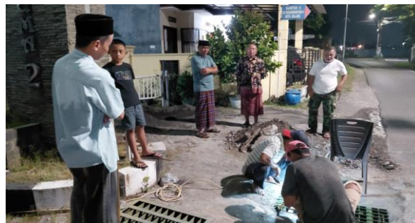
Gambar 21. Pengecatan Dilakukan dengan Kerja Lembur oleh Tukang Selagi Hari Tidak Hujan agar Hasil Pengecoran dan Pengecatannya Baik Disaksikan oleh Warga Sekitar.
